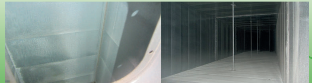
» Anlagenzustand mit Aerosolnachbehandlung
