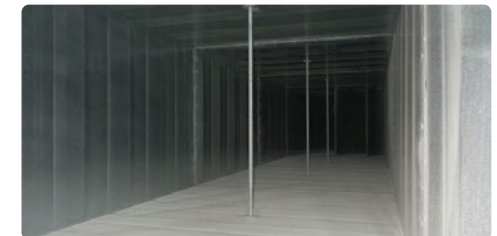
Anlagenzustand mit Aerosolnachbehandlung
